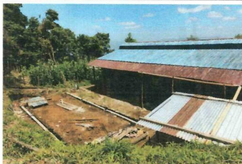
Foto 1: CUBIERTA DE LÁMINA. Las láminas del salón del centro educativo se encuentran un poco deterioradas, se les dará mantenimiento.
