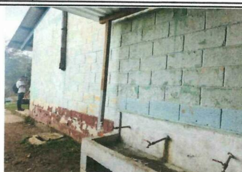
Foto 8: PINTURA EN MUROS INTERIOR Y EXTERIOR: La pintura de las paredes se encuentra en mal estado.
