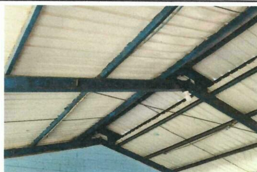
Foto 2: ESTRUCTURA DE TECHO. Las costaneras y vigas se encuentran un poco deterioradas y se les dará mantenimiento.
